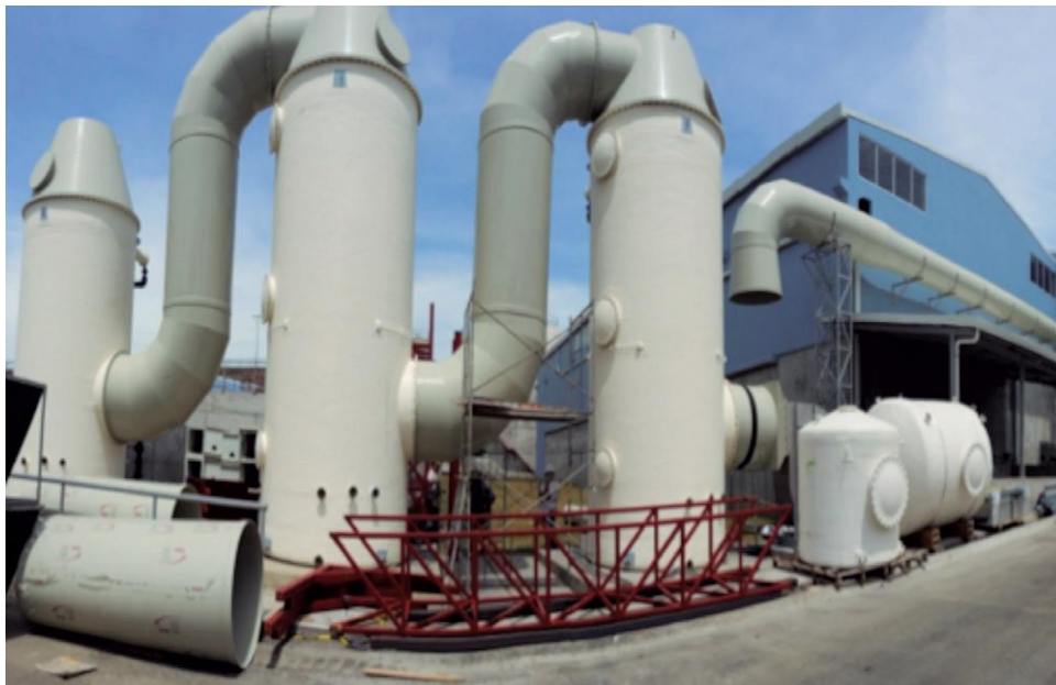
Figura No. 2. Sistema de tratamiento de olores.
