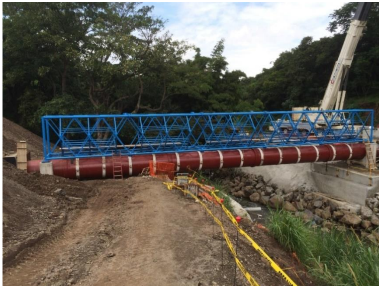
Figura No. 4. Detalle PC Torres, módulos y tubería colgante
