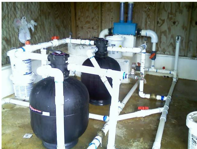
Figura 4.24. Tubería sin rosca – Comunidad Lijas, Las Piedras (foto por E. Montañez-junio 2007).
