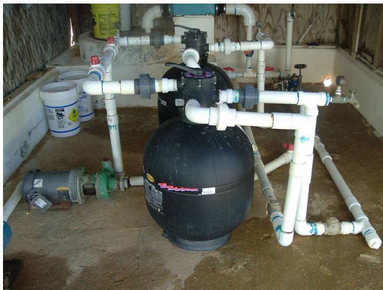
Figura 4.21. Filtros Lentos de Arena – Comunidad Lijas, Las Piedras.
