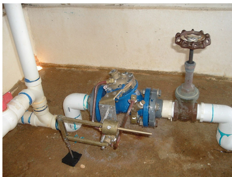
Figura 4.23. Válvula de Llenado – Comunidad Lijas, Las Piedras.
