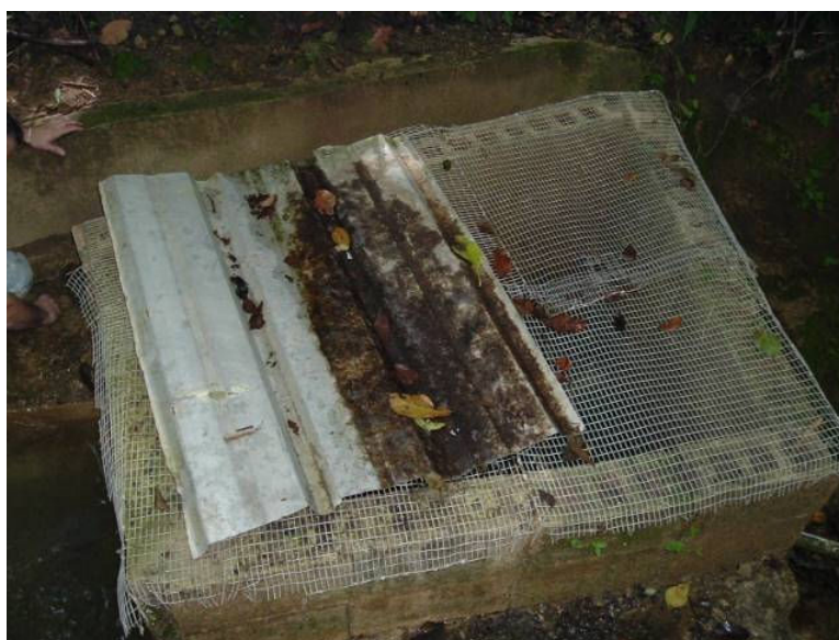
Figura 4.30. Tanque #2 con malla de protección en la parte superior – Comunidad Lijas, Las Piedras.
