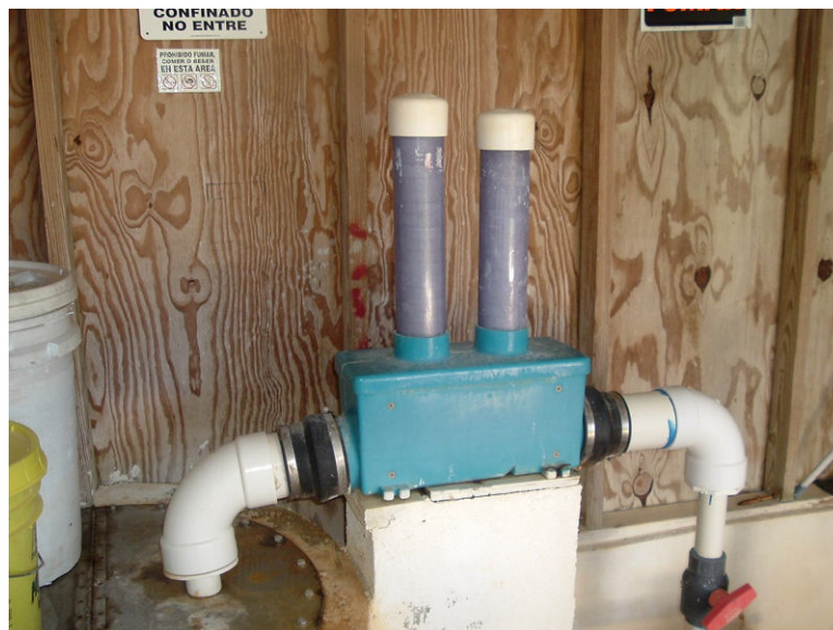
Figura 4.22. Clorador – Comunidad Lijas, Las Piedras.
