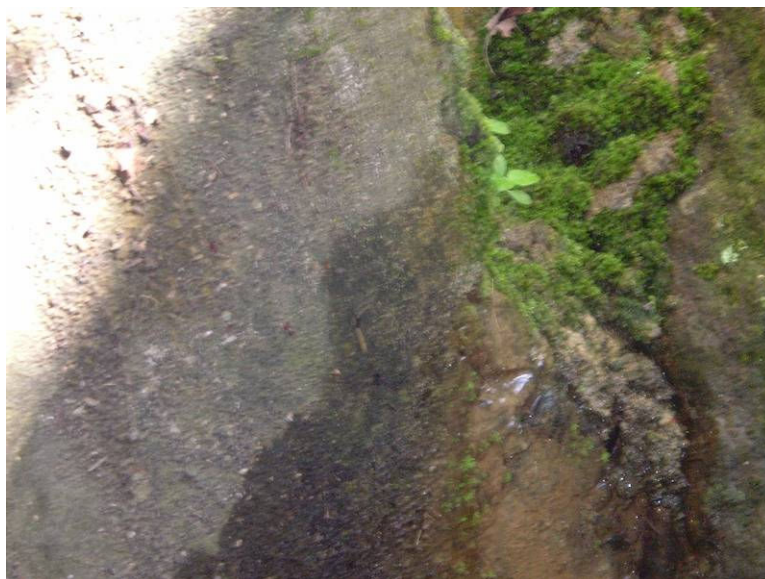
Figura 4.27. Tanque #3 con fuga de agua – Comunidad Lijas, Las Piedras.
