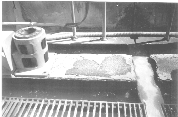
Figura 3. Vista parcial de tanquilla de mezcla rápida corroída, observada en la planta Angostura Ciudad Bolívar, Estado Bolívar.
